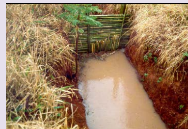
ETAPA 2 – Água retida na paliçada.
