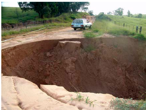
Chuva forte provoca voçoroca em rua de Marechal Rondon (Fonte: Portal Medianeira).
